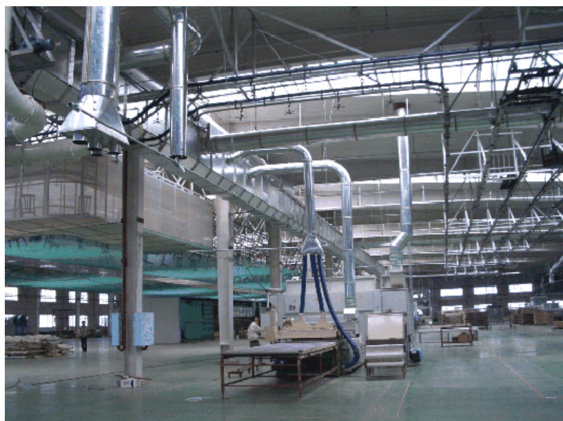
刮板输送除尘系统
